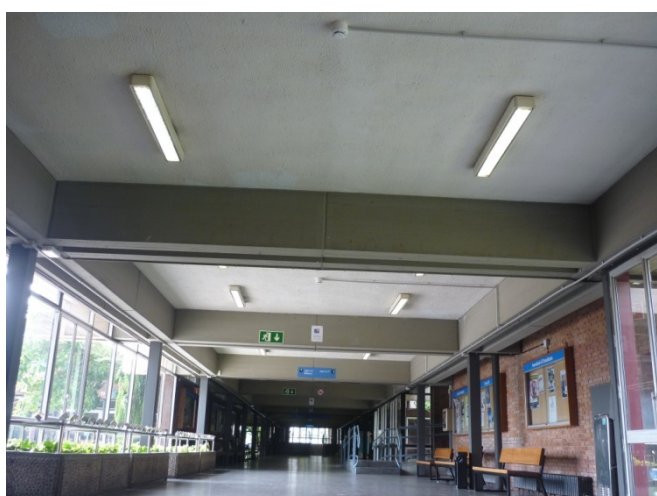
Figura 31. Il·luminació amb tubs de tecnologia LED a la Facultat d'Economia i Empresa (edifici Diagonal 690). Banc d'imatges OSSMA.
